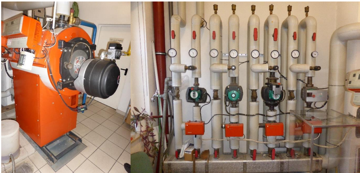
Abb. 36 Rathaus: Heizkessel (li) und Heizkreisverteilung (re)
