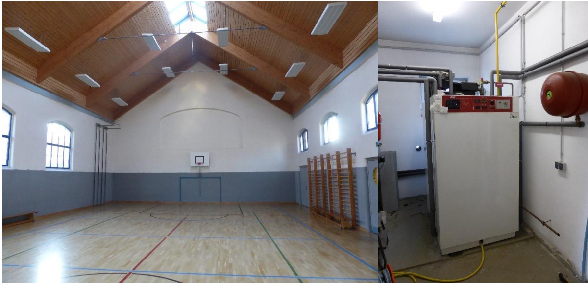
Abb. 34 Turnhalle an der Kirchstraße: Halle (li) und aktueller Wärmeezeuger für die Funktionsräume (re)
